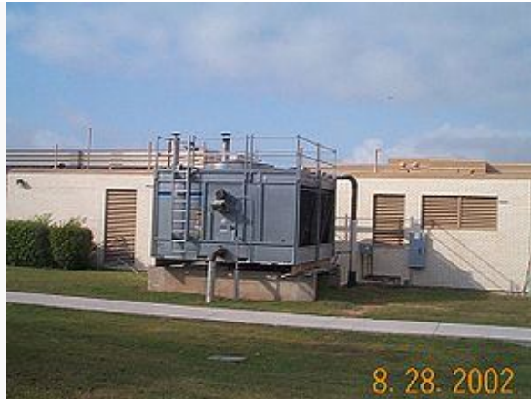
برج خنک کن ( با جریان هوای متقاطع )
